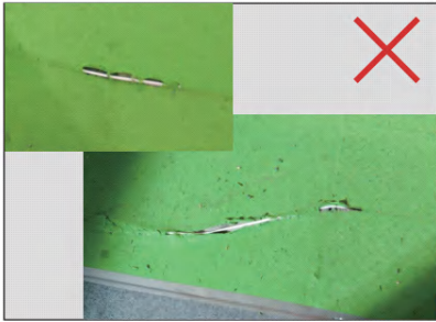
展位地面线路未使用线槽：不合格
